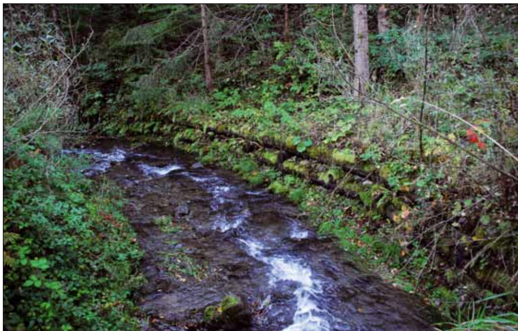
Fragment zabudowy brzegowej potoku Wielki Suchy w leśnictwie Leśnica. Fot. J. Gabryś
