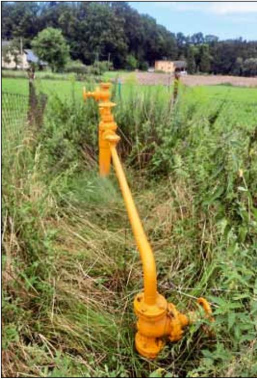
Naziemna instalacja nieczynnego odwiertu Dębowiec 40, 2020 r. Fot. K. Krzyżak
